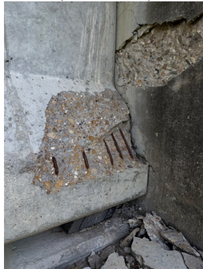
(d) Exposed Rebar on the Girder (LBB-RC-06)
