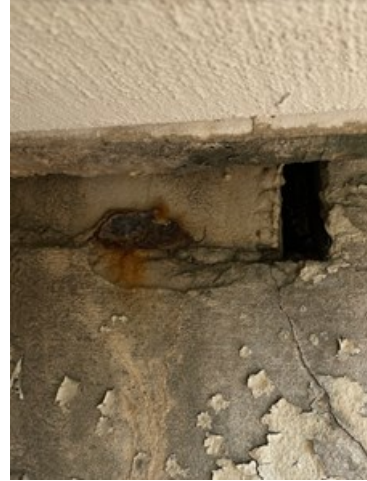
(d) Corrosion near bearing pad (FTW-RC-03)
