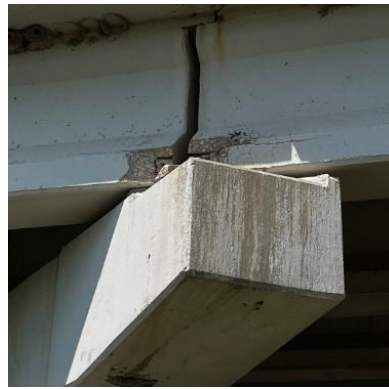
(d) Spalling at a Girder End
