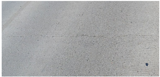
(d) Main PBJ crack
