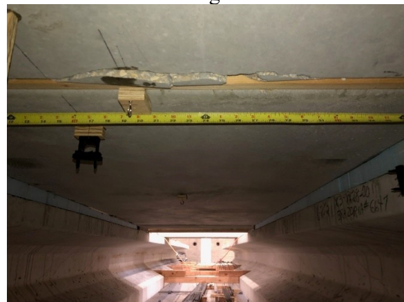
(d) PCP damage at board
